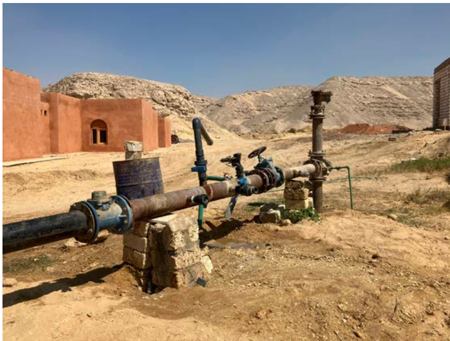
Installation de pompage d'une plantation bio en Égypte qui dispose d'un accès à une ressource hydrique renouvelable.
